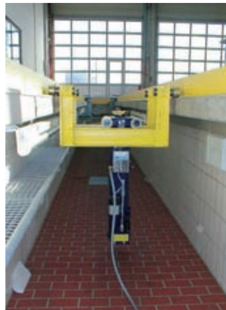
Подвесной домкрат передвигается по рельсовым направляющим, проложенным в оголовке смотровой ямы.
